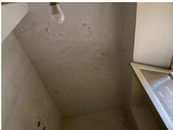
Foto n. 9 – soffitto e pareti del w.c.
