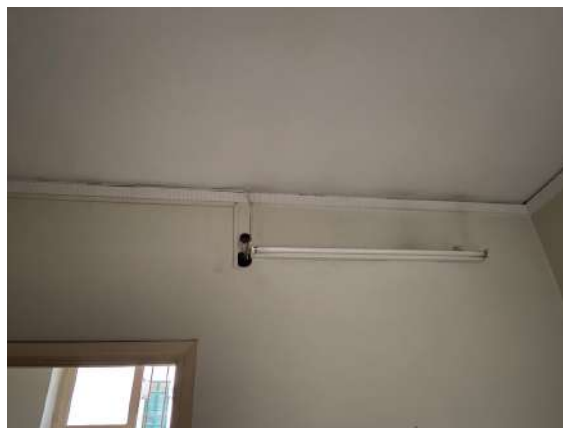
Foto n. 10 – impianto di illuminazione
