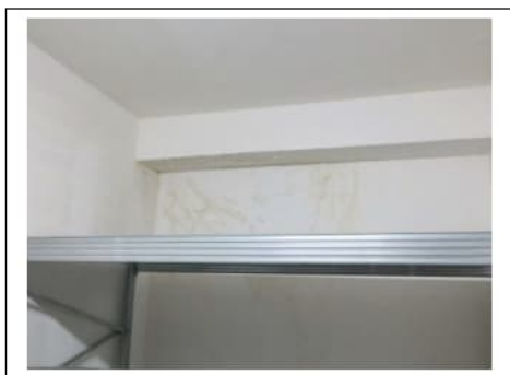
Fig. 30. Primo piano seminterrato. Box auto pignorato identificato al sub. 46. Degradi sulla parete di fondo e sulla trave
