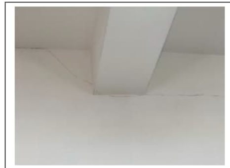
Fig. 29. Primo piano seminterrato. Box auto pignorato identificato al sub. 46. Fessurazioni sul tramezzo di separazione con il box sub. 47
