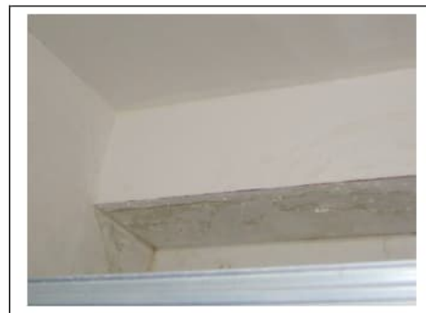
Fig. 31. Primo piano seminterrato. Box auto pignorato identificato al sub. 46. Degradi sulla parete di fondo e sulla trave
