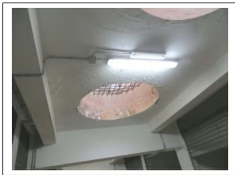
Fig. 20. Primo piano seminterrato. Degradi sul soffitto delle aree di manovra in corrispondenza dei lucernari di via Villa Heloise
