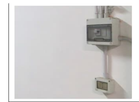
Fig. 33. Primo piano seminterrato. Box auto pignorato identificato al sub. 46. Quadro elettrico e interruttore
