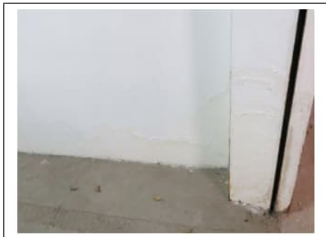
Fig. 28. Primo piano seminterrato. Box auto pignorato identificato al sub. 46. Manifestazioni di umidità dovuti ad assorbimento d'acqua dal pavimento
