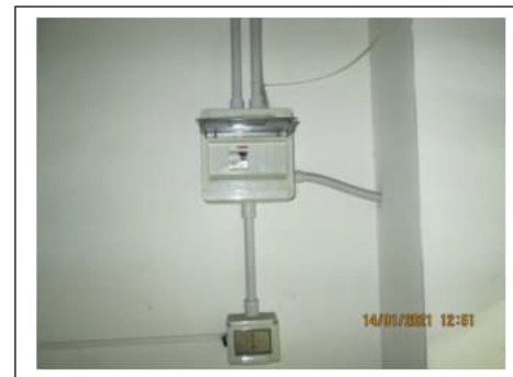
Fig. 29. Primo piano seminterrato. Box auto pignorato identificato al sub.42. Quadro elettrico e interruttore della luce
