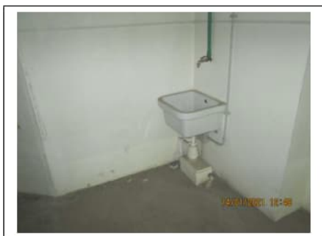
Fig. 28. Primo piano seminterrato. Box auto pignorato identificato al sub. 42. Punto acqua con piletta
