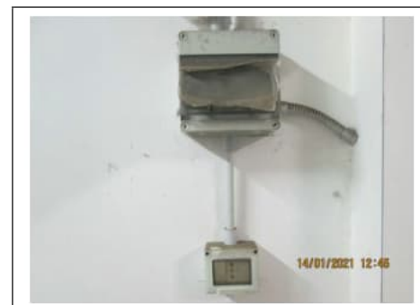
Fig. 29. Primo piano seminterrato. Box auto pignorato identificato al sub.40. Quadro elettrico e interruttore della luce
