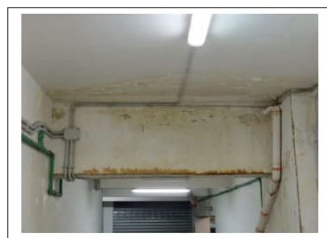
Fig. 23. Primo piano seminterrato. Degradi su una trave in prossimità della rampa di accesso dal civico 22 di via Villa Heloise
