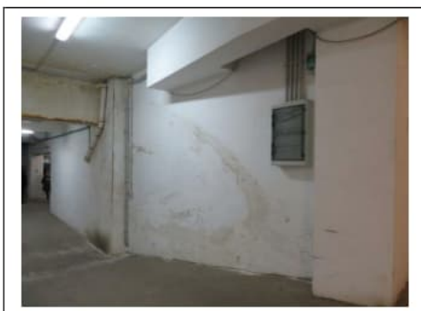
Fig. 22. Primo piano seminterrato. Degradi su una parete in prossimità della rampa di accesso dal civico 22 di via Villa Heloise
