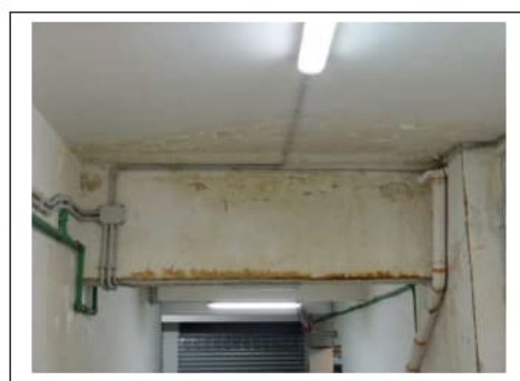
Fig. 23. Primo piano seminterrato. Degradi su una trave in prossimità della rampa di accesso dal civico 22 di via Villa Heloise
