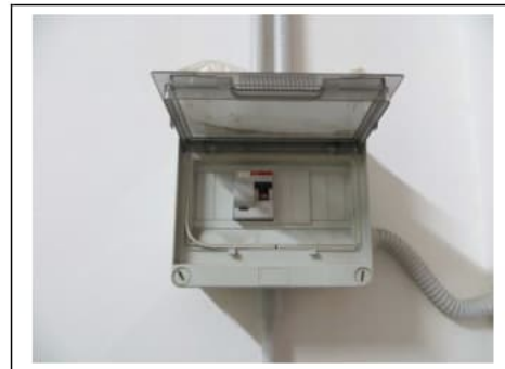
Fig. 29. Primo piano seminterrato. Box auto pignorato identificato al sub. 45. Quadro elettrico
