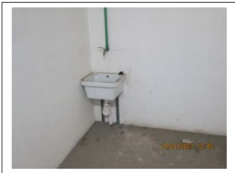
Fig. 30. Primo piano seminterrato. Box auto pignorato identificato al sub. 35. Piletta con punto acqua
