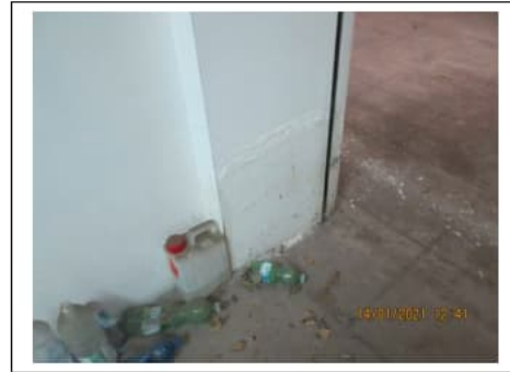
Fig. 29. Primo piano seminterrato. Box auto pignorato identificato al sub. 35. Aloni di umidità dovuti ad assorbimento d'acqua dal pavimento
