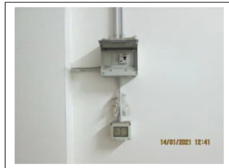
Fig. 31. Primo piano seminterrato. Box auto pignorato identificato al sub. 35. Quadro elettrico
