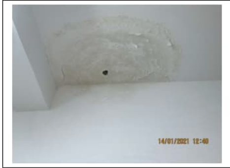
Fig. 28. Primo piano seminterrato. Box auto pignorato identificato al sub. 35. Degradi sul soffitto.
