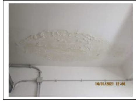
Fig. 27. Primo piano seminterrato. Box auto pignorato identificato al sub. 36. Degradi sul soffitto
