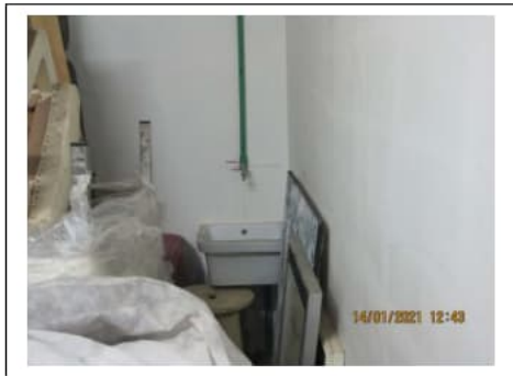
Fig. 28. Primo piano seminterrato. Box auto pignorato identificato al sub. 36. Piletta con punto acqua
