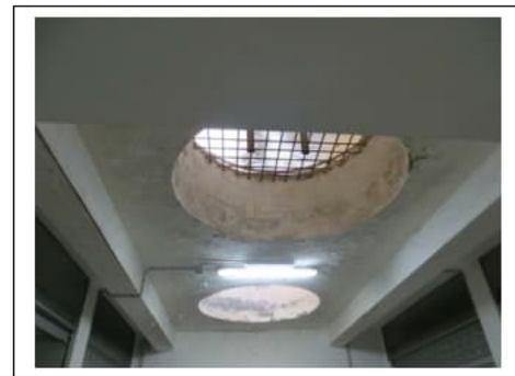
Fig. 21. Primo piano seminterrato. Degradi sul soffitto delle aree di manovra in corrispondenza dei lucernari di via Villa Heloise
