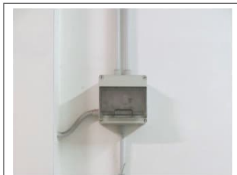
Fig. 29. Primo piano seminterrato. Box auto pignorato identificato al sub. 33. Quadro elettrico
