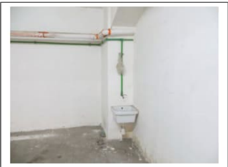
Fig. 30. Primo piano seminterrato. Box auto pignorato identificato al sub. 38. Piletta con punto acqua.
