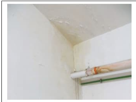
Fig. 28. Primo piano seminterrato. Box auto pignorato identificato al sub. 38. Degradi su soffitto e su porzione della parete sotto la rampa di accesso dal civ. 22.
