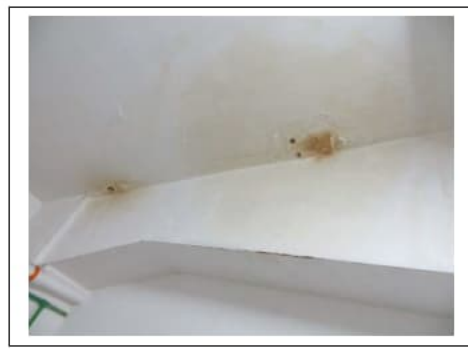
Fig. 29. Primo piano seminterrato. Box auto pignorato identificato al sub. 38. Degradi su soffitto lungo la trave confinante con la rampa adiacente al box.
