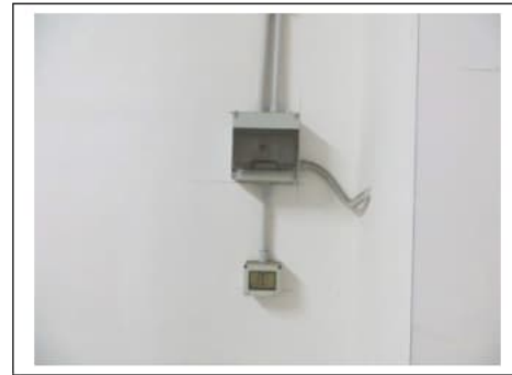
Fig. 31. Primo piano seminterrato. Box auto pignorato identificato al sub. 38. Quadro elettrico.
