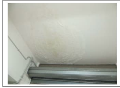
Fig. 27. Primo piano seminterrato. Box auto pignorato identificato al sub. 38. Degradi sul soffitto vicino la saracinesca.
