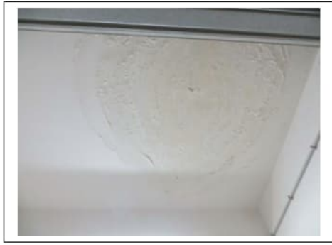
Fig. 26. Primo piano seminterrato. Box auto pignorato identificato al sub. 38. Degradi su soffitto vicino la saracinesca.
