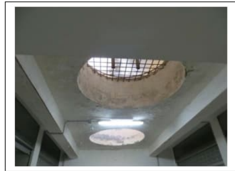
Fig. 21. Primo piano seminterrato. Degradi sul soffitto delle aree di manovra in corrispondenza dei lucernari di via Villa Heloise
