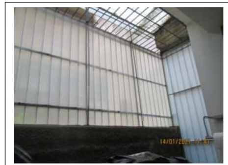
Fig. 29. Primo piano seminterrato. Box auto pignorato identificato al sub. 27. Pannelli in policarbonato protetti da grate a confine con l'intercapedine sul lato nord-ovest
