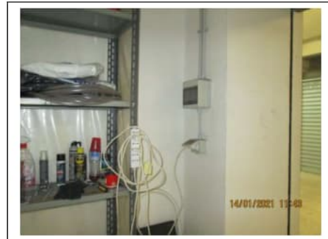
Fig. 27. Primo piano seminterrato. Box auto pignorato identificato al sub. 27. Quadro elettrico
