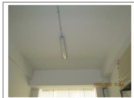
Fig. 31. Primo piano seminterrato. Box auto pignorato identificato al sub. 27. Punto luce a soffitto
