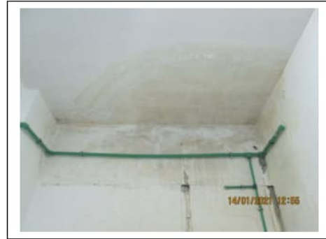
Fig. 27. Primo piano seminterrato. Box auto pignorato identificato al sub. 31. Degradi sul soffitto e sulle pareti
