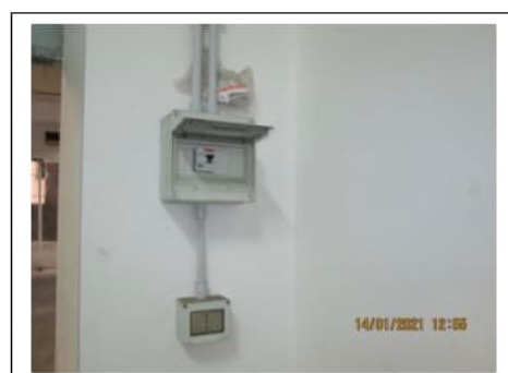
Fig. 29. Primo piano seminterrato. Box auto pignorato identificato al sub. 31. Quadro elettrico
