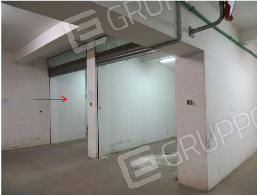
Foto 1. Primo piano seminterrato. Box auto pignorato identificato al sub. 39 (indicato con la freccia)
