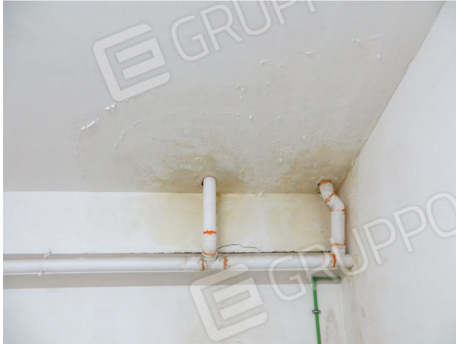
Foto 5. Primo piano seminterrato. Box auto pignorato identificato al sub. 39. Degradi sul soffitto e sulla parete di fondo sotto la rampa avente accesso dal civ. 22 di via Villa Heloise
