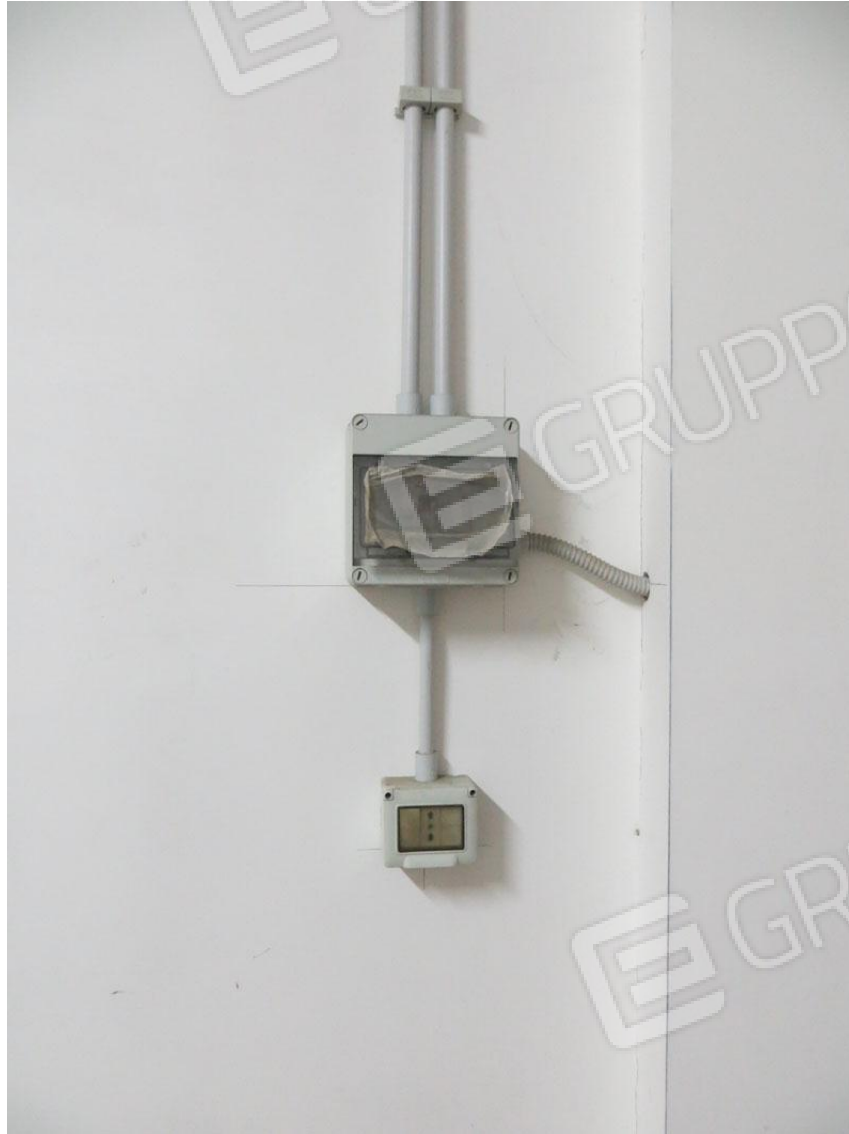
Foto 7. Quadro elettrico e interruttore della luce
