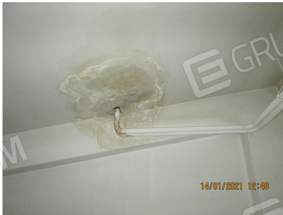
Foto 4. Primo piano seminterrato. Box auto pignorato identificato al sub 42. Infiltrazioni d'acqua sul soffitto
