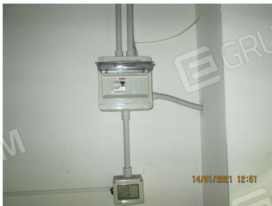
Foto 6. Primo piano seminterrato. Box auto pignorato identificato al sub 42. Quadro elettrico e interruttore con presa
