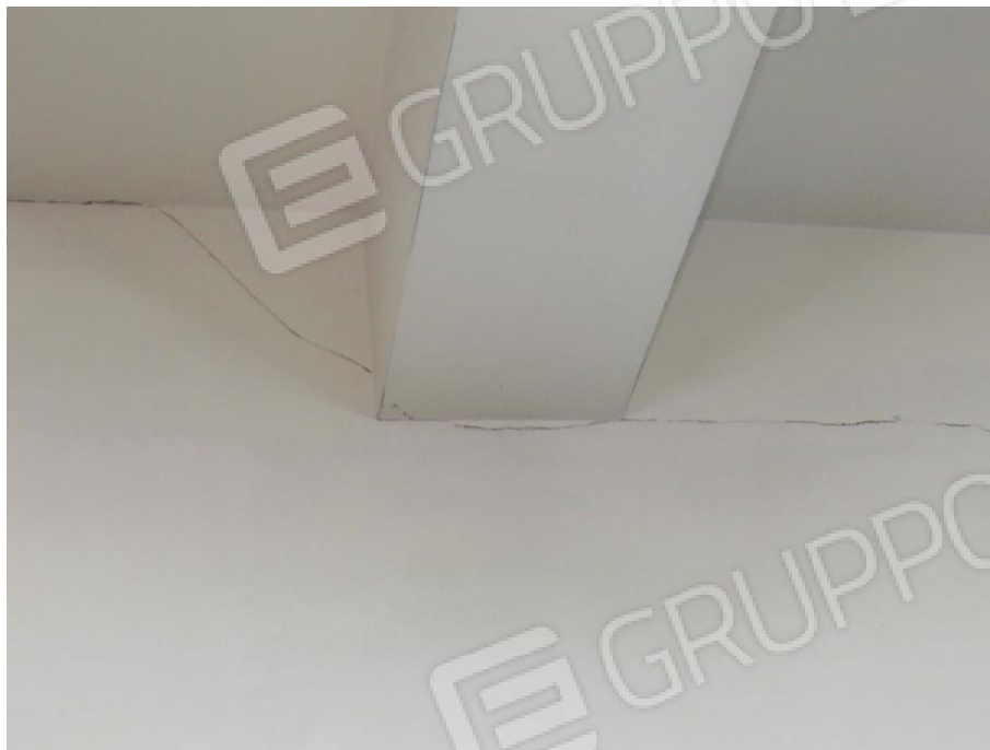
Foto 7. Primo piano seminterrato. Box auto pignorato identificato al sub 46. Fessurazione sul tramezzo di separazione con box auto sub. 47
