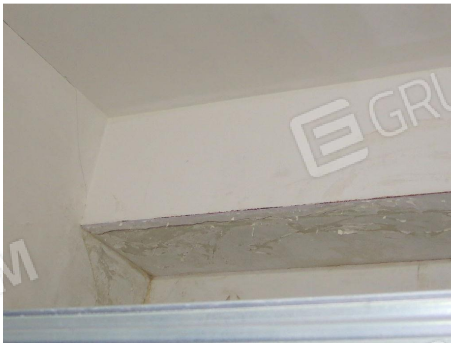
Foto 6. Primo piano seminterrato. Box auto pignorato identificato al sub 45. Infiltrazioni sulla parete di fondo e sulla trave
