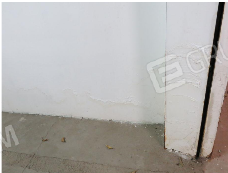
Foto 8. Primo piano seminterrato. Box auto pignorato identificato al sub 46. Tracce di umidità sulla zona basamentale, esito di allagamenti
