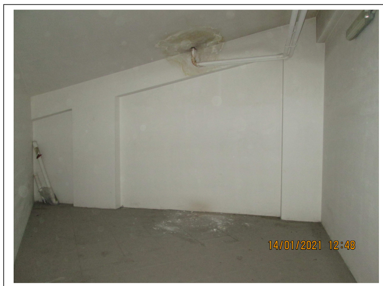
Foto 28. Soffitto del box sub. 42 con aloni di umidità attorno alla tubazione proveniente dal piano superiore (fotografato in occasione del sopralluogo del 14/01/2022)
