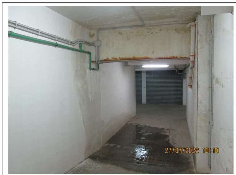
Foto 32. Trave ammalorata della corsia comune compresa tra il box sub. 37 e il box sub. 38. E' visibile presenza di acqua sulla parete del box sub. 37, sulla trave e sul pavimento
