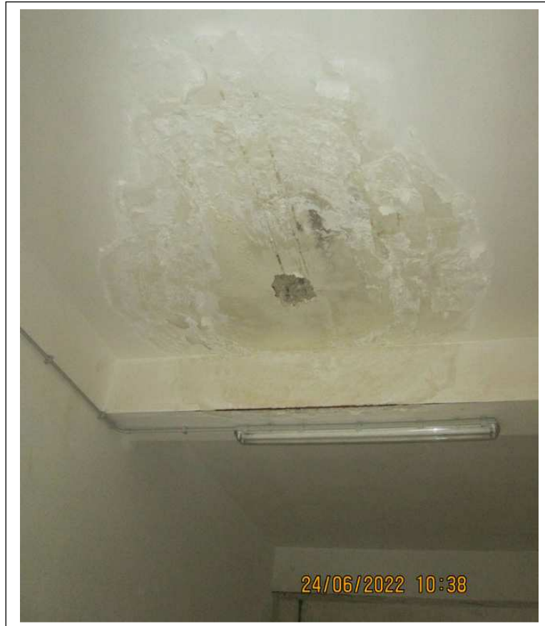
Foto 5. Box sub. 32. Degradi sulla porzione di soffitto più vicina all'ingresso
