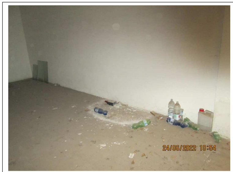
Foto 10. Box sub. 35. Macchia sul pavimento conseguenza del gocciolamento del soffitto
