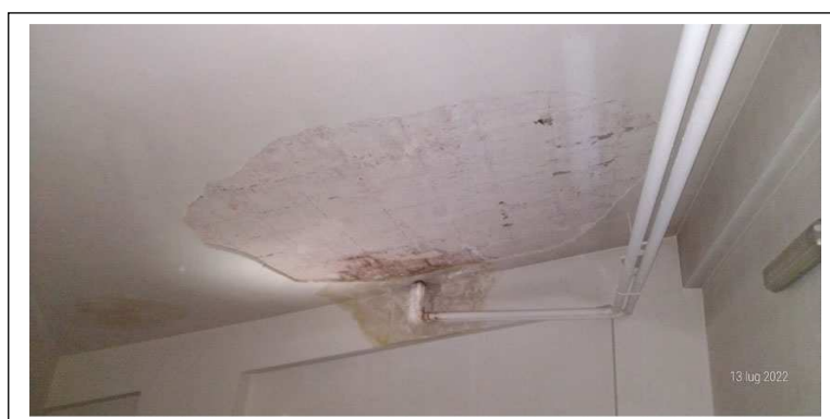
Foto 29. Soffitto del box sub. 42 con aloni di umidità attorno alla tubazione proveniente dal piano superiore e distacco di vasta porzione dell'intonaco dell'intradosso (fotografato in occasione del sopralluogo del 13/07/2022)
