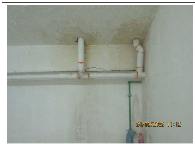
Foto 13-14. Box sub. 39. Degradati sulla trave della parete di fondo e sul soffitto in corrispondenza di tubazioni
