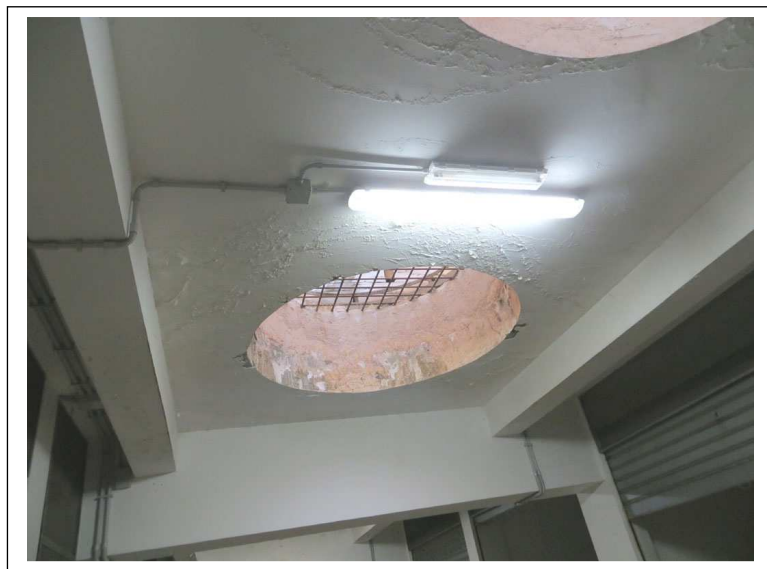
Foto 17-18. Soffitti ammalorati degli spazi comuni di manovra in corrispondenza delle aiole e dei lucernari di via Villa Heloise
