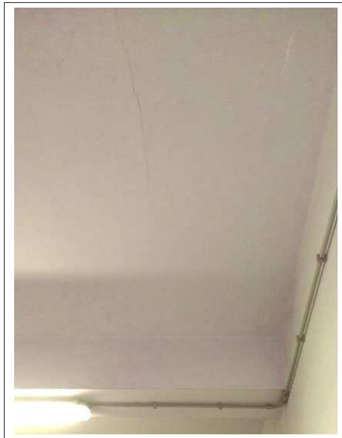
Foto 16. Box sub. 44. Fessurazione dell'intradosso
