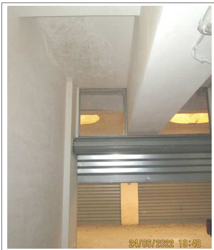
Foto 7. Box sub. 34. Degradi sulla porzione di soffitto più vicina all'ingresso
