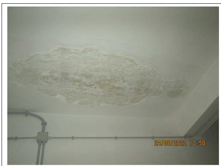
Foto 8. Box sub. 36. Degradi sulla porzione di soffitto più vicina all'ingresso
