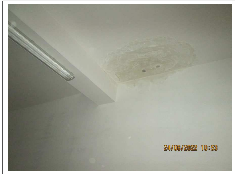
Foto 9. Box sub. 35. Degradati sulla porzione di soffitto più vicina all'ingresso
