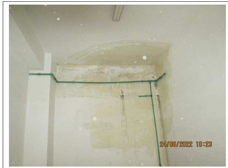
Foto 1. Box sub. 31. Degradi sulla parete di fondo, sulla trave e sul soffitto
