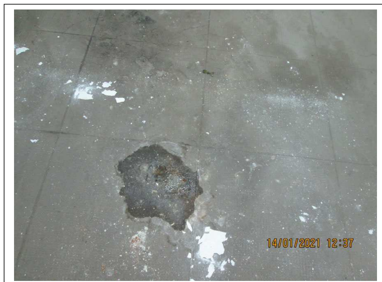
Foto 6. Box sub. 32. Chiazza di acqua sul pavimento conseguenza del gocciolamento del soffitto
