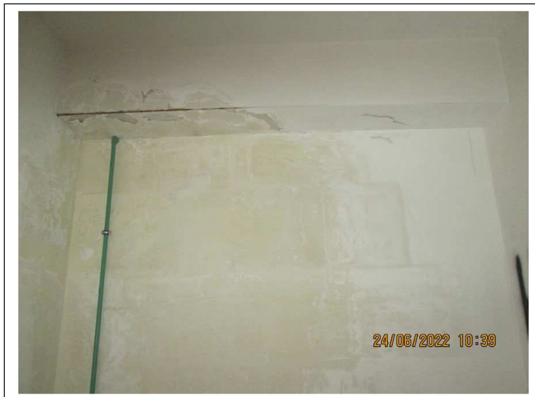
Foto 3. Box sub. 32. Degradi sulla parete di fondo e sulla trave
