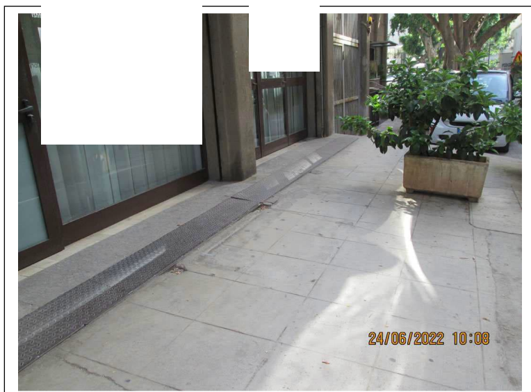
Foto 23. Marciapiede compreso tra i civici n. 24 e 36 di via Villa Heloise
