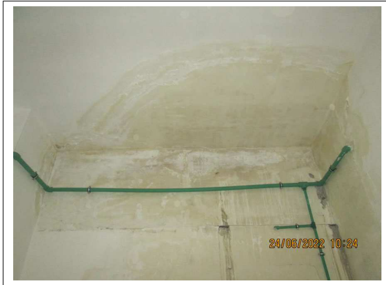
Foto 2. Box sub. 31. Degradi sulla parete di fondo, sulla trave e sul soffitto
