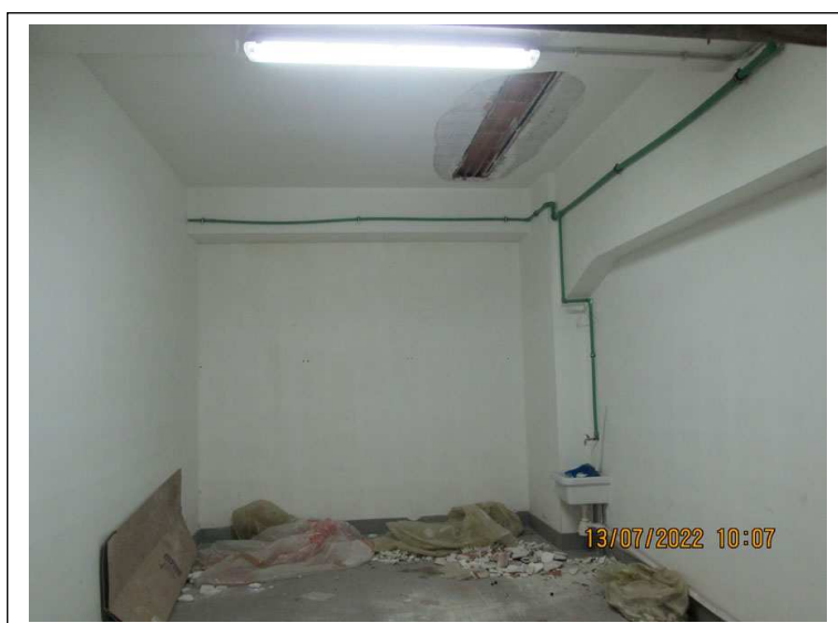
Foto 31. Soffitto del box sub. 48 con porzione dell'intradosso sfondata in corrispondenza della pregressa fessurazione (fotografato in occasione del sopralluogo del 13/07/2022)
