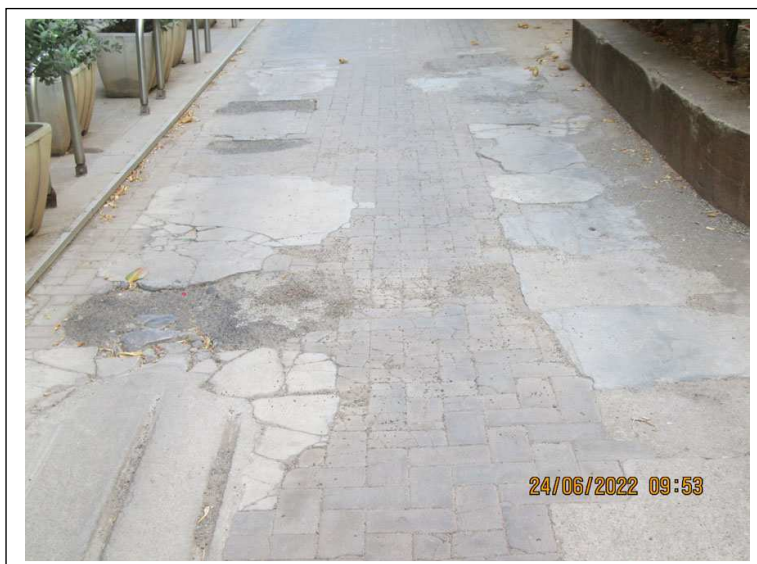
Foto 20-21-22. Via Villa Heloise, manto stradale dissestato
