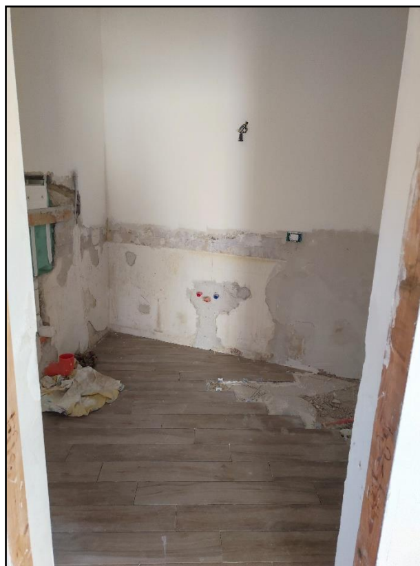
W.C. : interno privo di rivestimento parietale e sanitari
