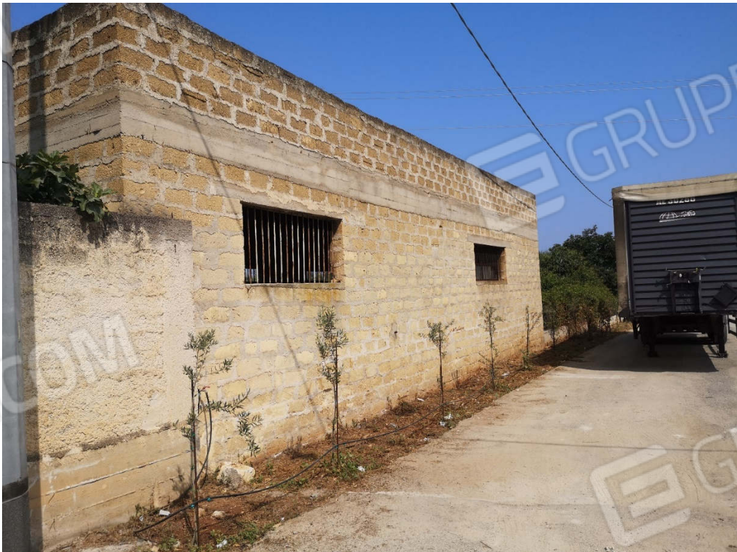
4. Prospetto est su p.lla 1240 (porzione abusiva)
