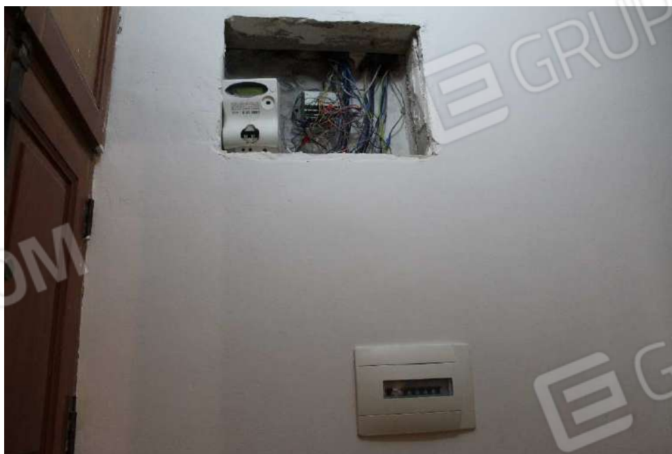
Foto n. 34 – Contatore per la fornitura di corrente elettrica e relativo pannello.
