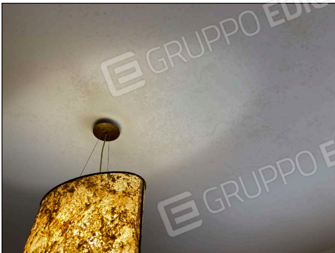
Foto n. 19 - Interni: dettaglio umidità di condensa sul soffitto della camera da letto
