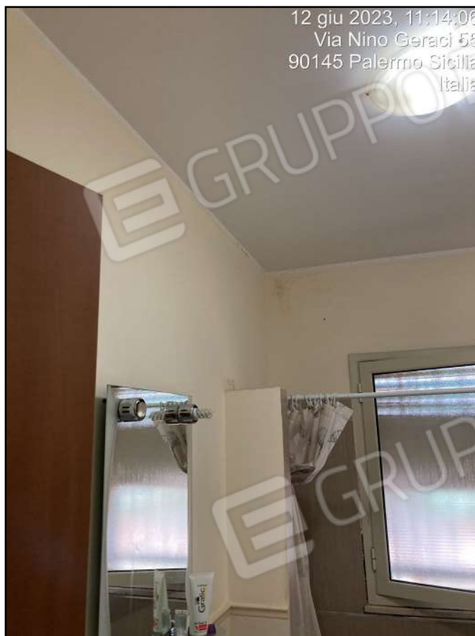
Foto n. 17 - Interni: Segni di condensa nel bagno grande
