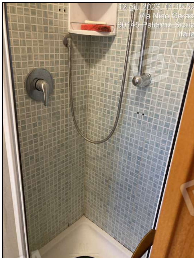
Foto n. 24 - Interni: w.c. doccia, interno alla camera da letto
