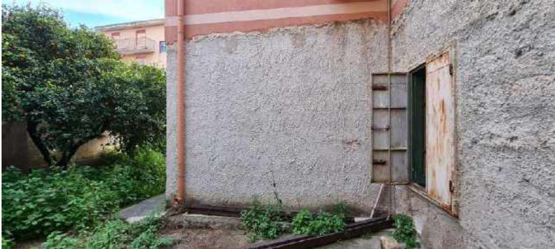
Magazzino/locale deposito-Infisso vano pranzo – Retrospetto
