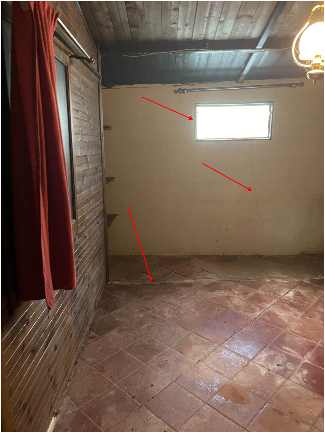
Foto particolare camera con a terra traccia della parete spostata, della lesione di parete e della apertura non autorizzata.
