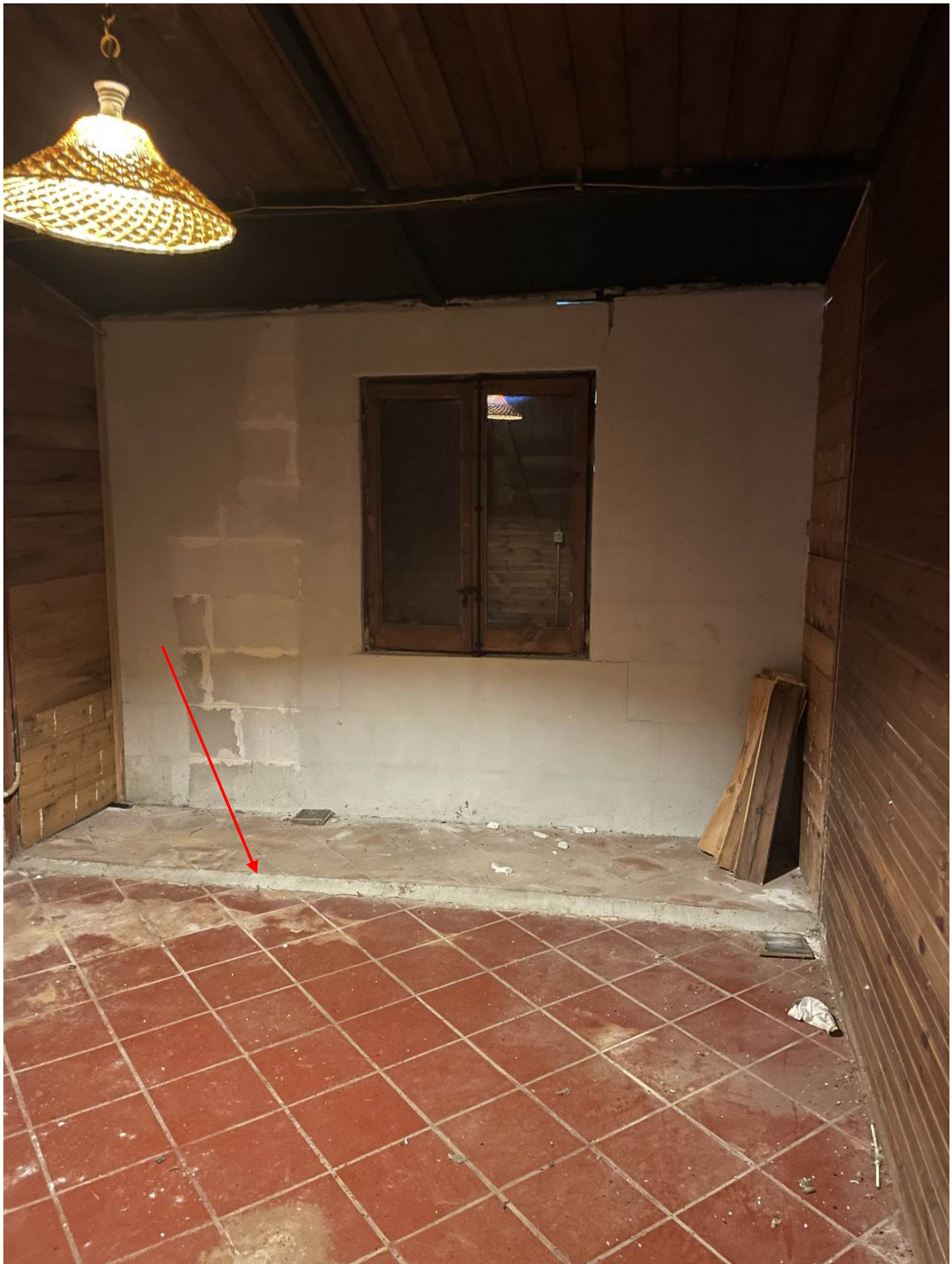
Foto particolare camera con a terra traccia della parete spostata
