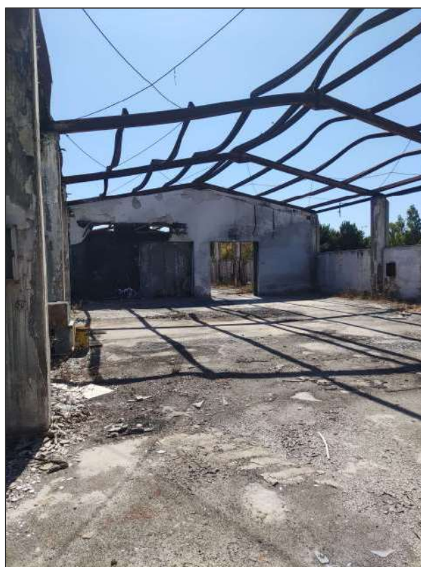
Copertura Corpo B. Deformazioni delle travi in ferro.
