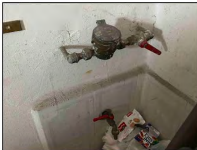
Contatore d'acqua e lavatoio
