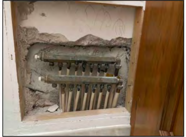
Collettori impianto di riscaldamento
