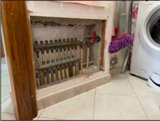
Collettori impianto idrico
