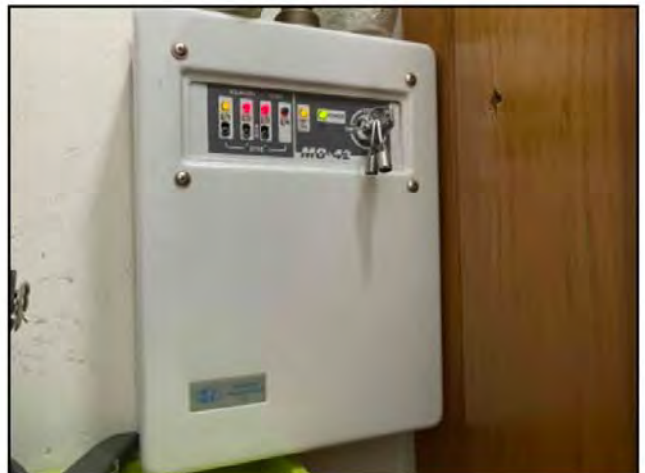
Centralina impianto di allarme
