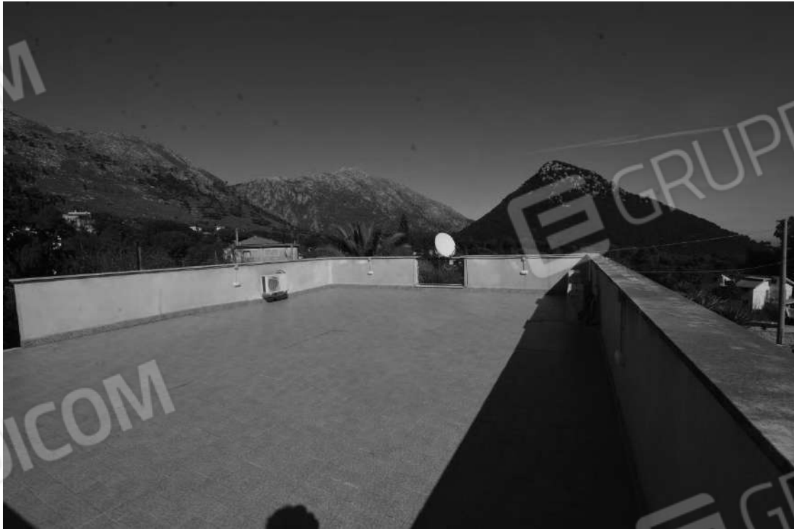
Foto 23 – u.i “B.” – Lastrico solare di primo piano della villetta di Via SM 14 n. 4
