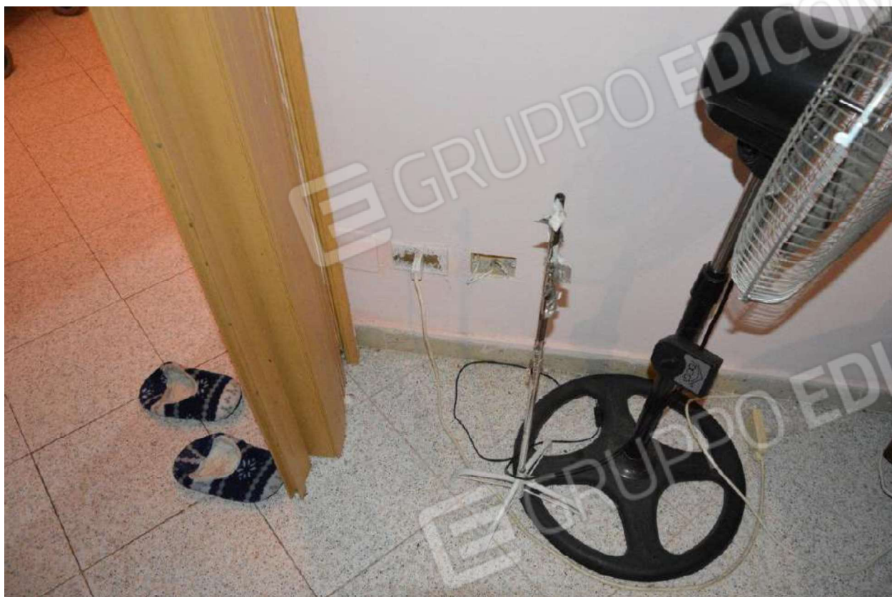
FOTO 17. Particolare impianto elettrico
