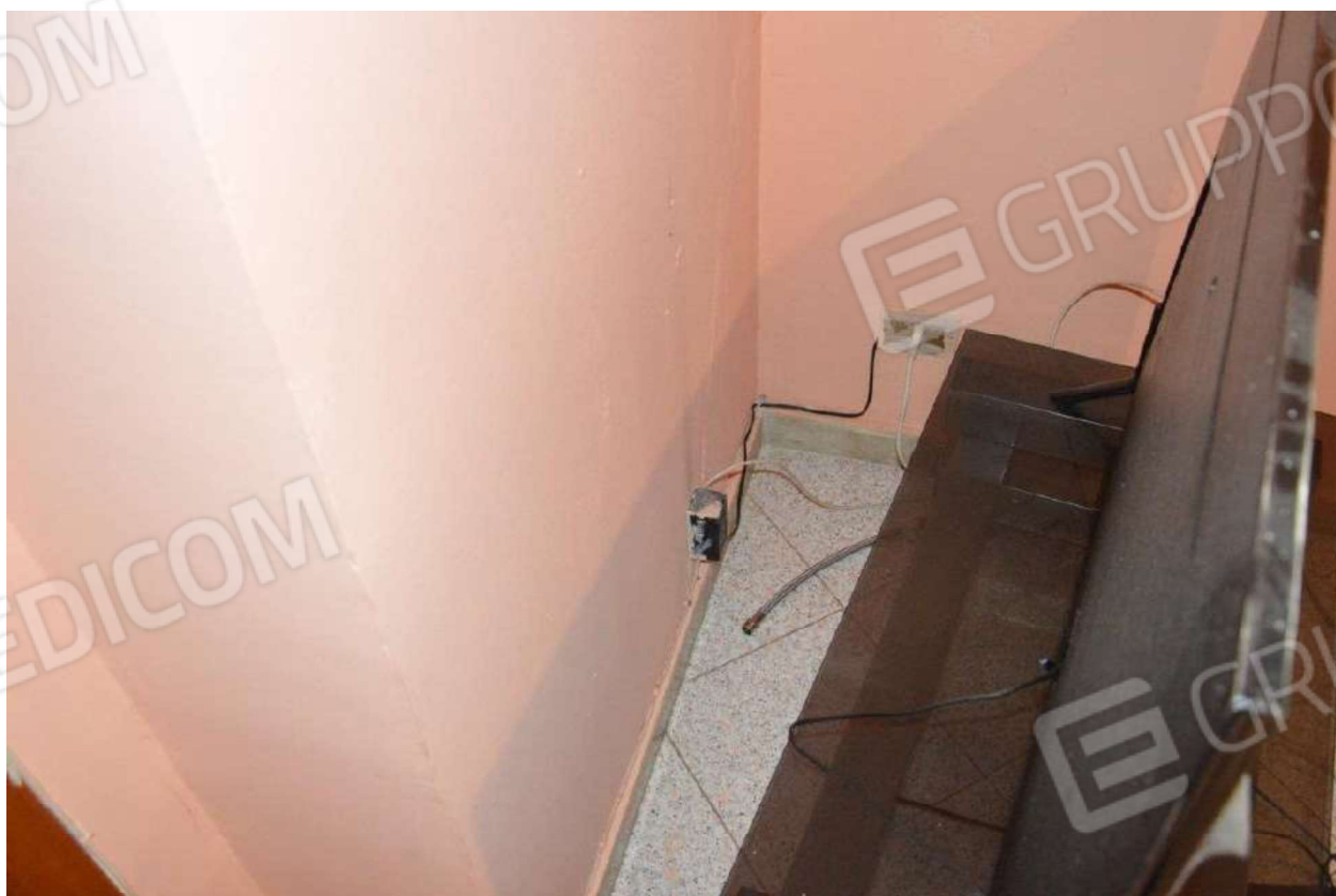
FOTO 18. Particolare impianto elettrico
