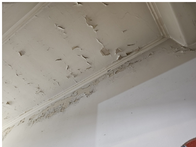
Foto 28 segni di ammaloramento sul soffitto del corridoio
