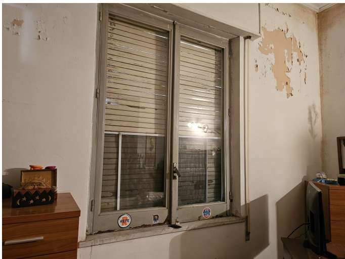
Foto 27 camera 03 infissi vetusti e segni di ammaloramento
