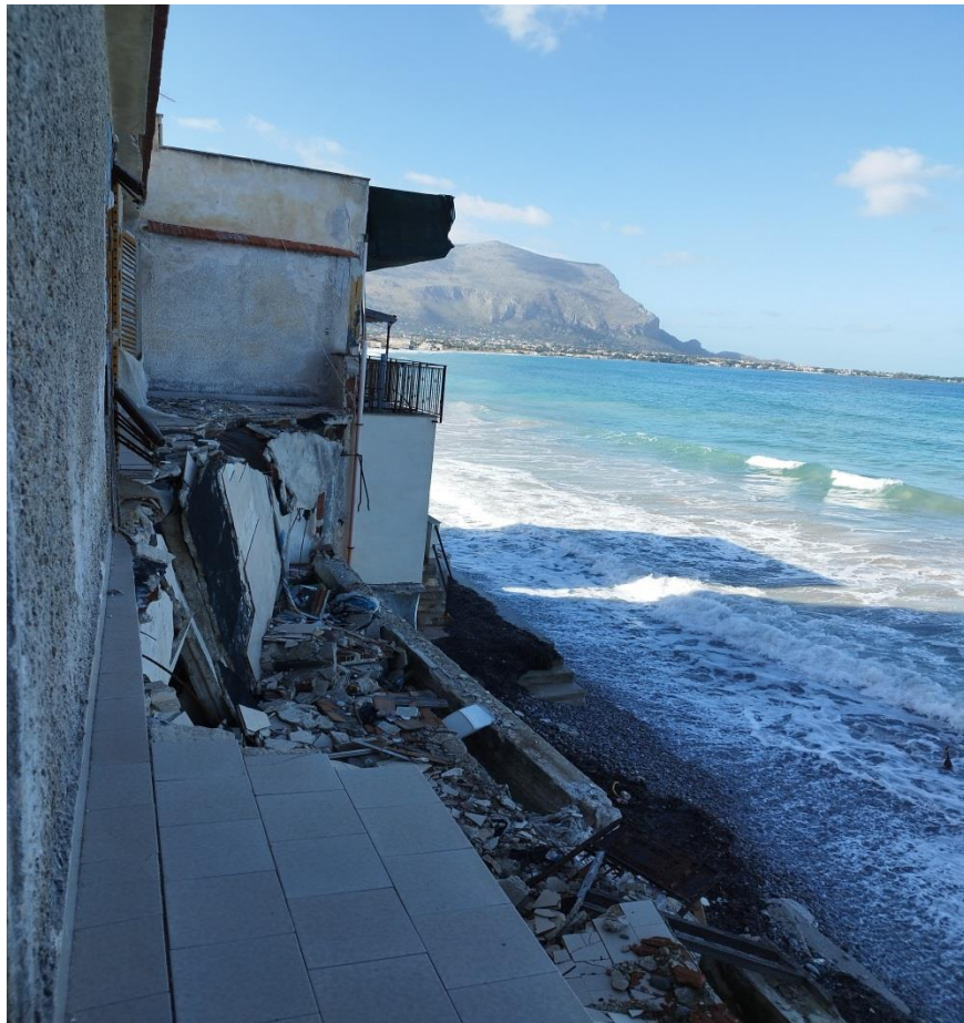
Terrazzo primo piano crollato
