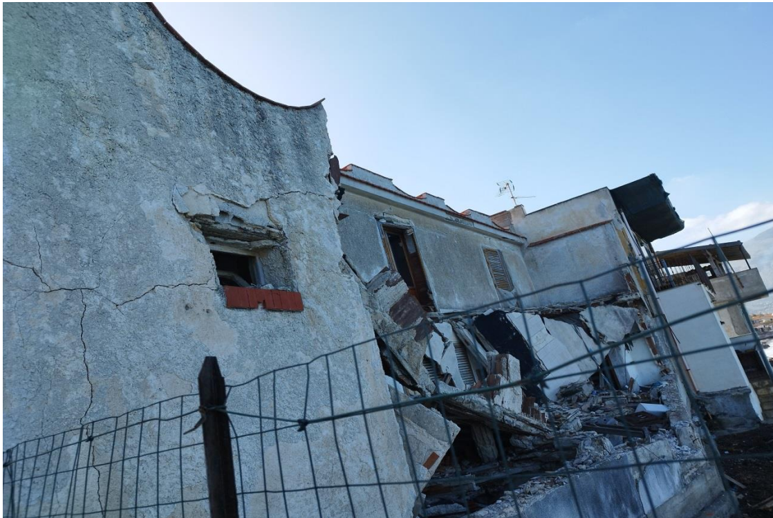
Crollo - depositi 1 e 2 + terrazzo su portico – fronte mare
