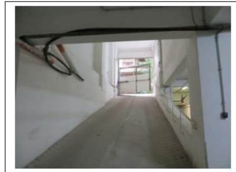
Fig. 13. Rampa del primo piano scantinato con ingresso dal civico n. 38 di via Villa Heloise
