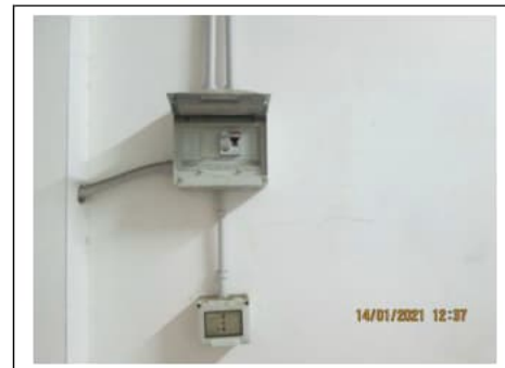
Fig. 29. Primo piano seminterrato. Box auto pignorato identificato al sub. 32. Quadro elettrico
