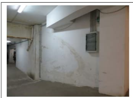
Fig. 22. Primo piano seminterrato. Degradi su una parete in prossimità della rampa di accesso dal civico 22 di via Villa Heloise
