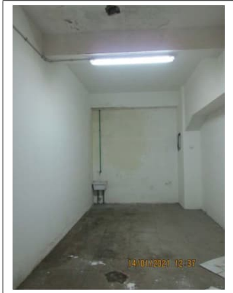
Fig. 26. Primo piano seminterrato. Box auto pignorato identificato al sub. 32. Interno. Degradi sul soffitto e sulle pareti
