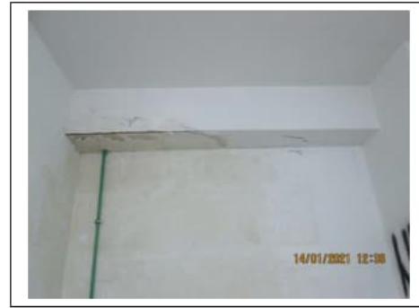
Fig. 27. Primo piano seminterrato. Box auto pignorato identificato al sub. 32. Degradi sulle pareti
