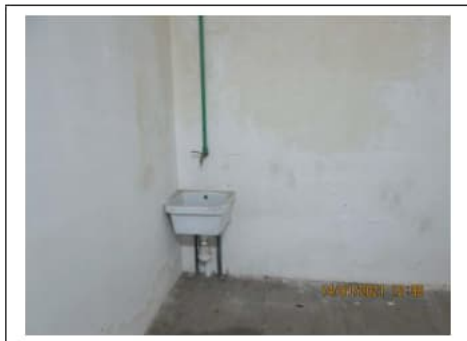
Fig. 28. Primo piano seminterrato. Box auto pignorato identificato al sub. 32. Piletta con punto acqua
