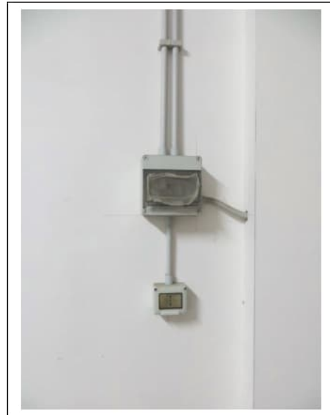
Fig. 31. Primo piano seminterrato. Box auto pignorato identificato al sub. 39. Quadro elettrico
