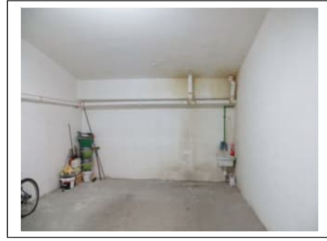
Fig. 27. Primo piano seminterrato. Box auto pignorato identificato al sub. 39. Degradi sul soffitto vicino la saracinesca
