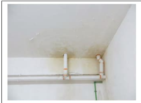
Fig.28. Primo piano seminterrato. Box auto pignorato identificato al sub. 39. Degradi su soffitto e su porzione della parete sotto la rampa di accesso dal civ. 22
