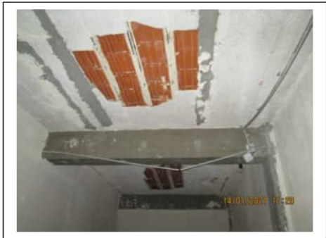
Fig. 50. Secondo piano scantinato. Soffitti sfondellati
