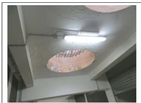
Fig. 28. Primo piano seminterrato. Degradi sul soffitto delle aree di manovra in corrispondenza dei lucernari di via Villa Heloise
