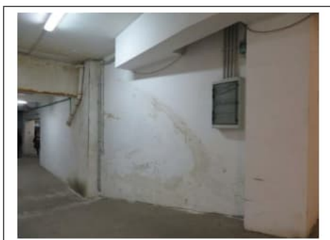
Fig. 30. Primo piano seminterrato. Degradi su una parete in prossimità della rampa di accesso dal civico 22 di via Villa Heloise
