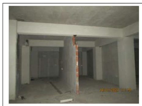
Fig. 35. Secondo piano scantinato. Box auto attigui al box antistante la rampa di accesso
