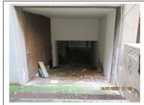
Fig. 21. Rampa del secondo piano scantinato con ingresso dal civico n. 20 di via Villa Heloise
