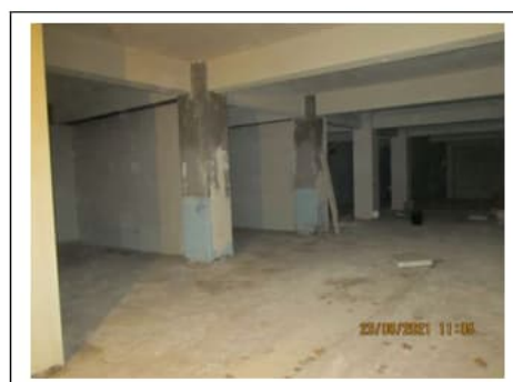
Fig. 39. Secondo piano scantinato, corsia di transito e box attigui al blocco ascensore
