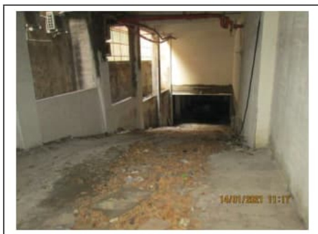
Fig. 24. Rampa del secondo piano scantinato con ingresso dal civico n. 20 di via Villa Heloise
