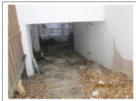
Fig. 22. Rampa del secondo piano scantinato con ingresso dal civico n. 20 di via Villa Heloise
