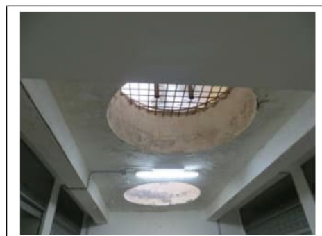
Fig. 29. Primo piano seminterrato. Degradi sul soffitto delle aree di manovra in corrispondenza dei lucernari di via Villa Heloise
