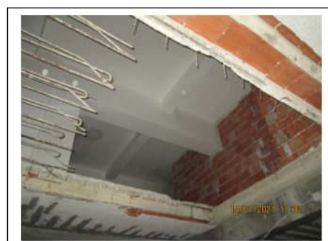
Fig. 55. Secondo piano scantinato. Zona nord-est. Foro su solaio di interpiano
