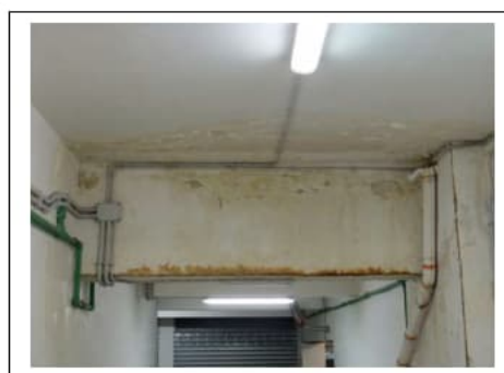
Fig. 33. Primo piano seminterrato. Degradi su una parete in prossimità della rampa di accesso dal civico 22 di via Villa Heloise
