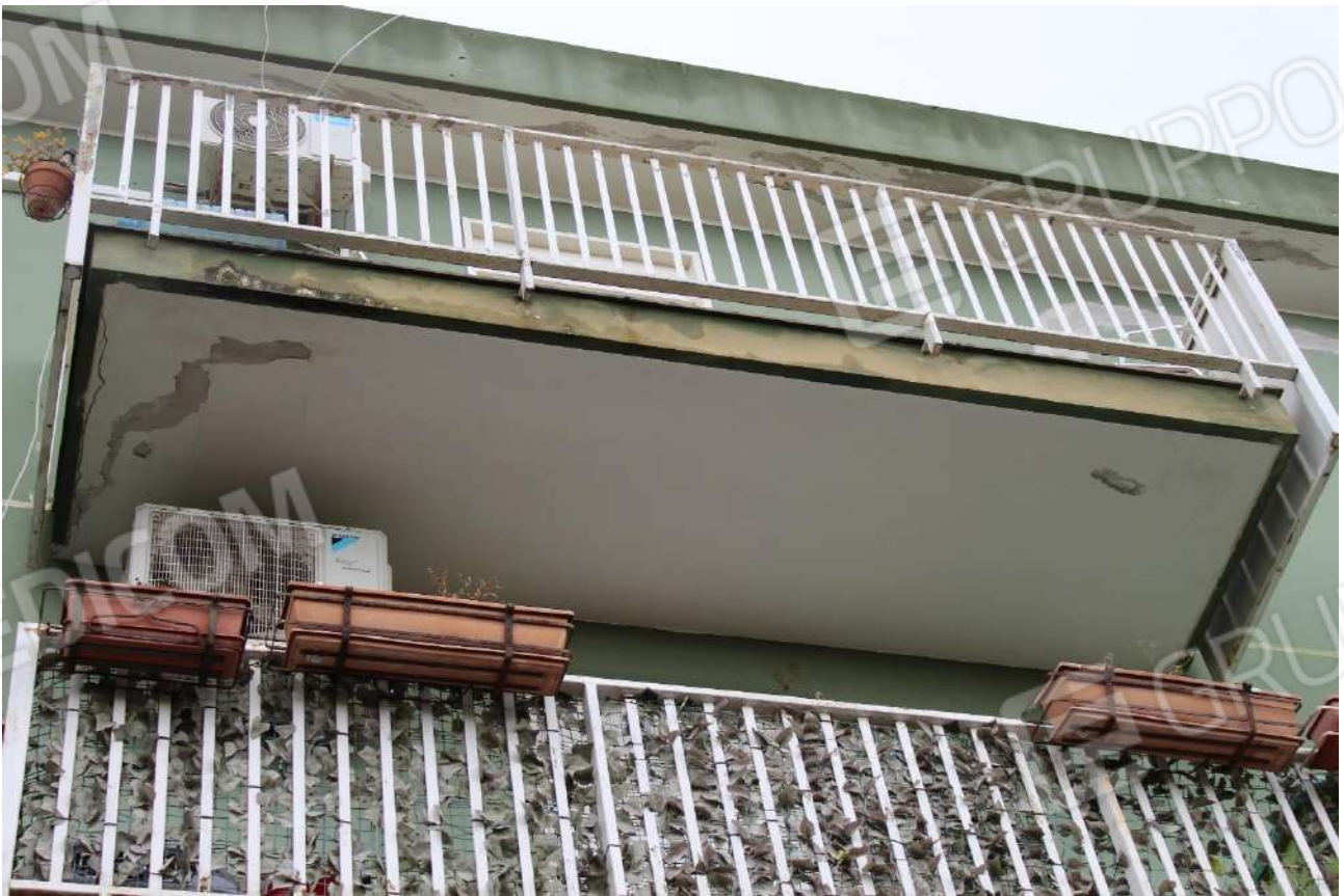
Balcone su prospetto principale con frontalino e intradosso danneggiati
