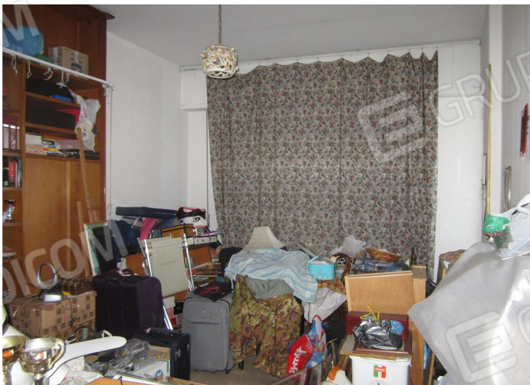
Foto 10: la camera a sinistra dell'ingresso, con affaccio verso la via A. Gravina e servito, attraverso una piccola portafinestra, da un balcone con lo stesso affaccio
