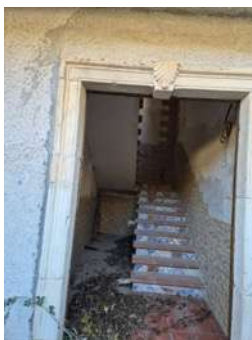
Foto 5 – Ingresso privo di infisso
