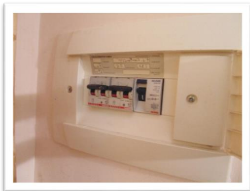
particolare del quadretto elettrico
