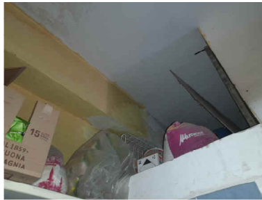
Foto 5 Infiltrazioni in corrispondenza dell'area wc
