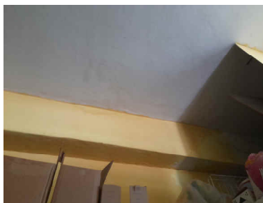
Foto 6 Infiltrazioni in corrispondenza dell'area wc – foto 2
