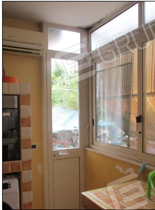
Foto 19 – tracce di umidità da condensa
