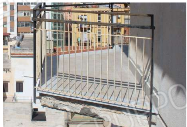
CM8: Frontalino e intradosso balcone (D).
