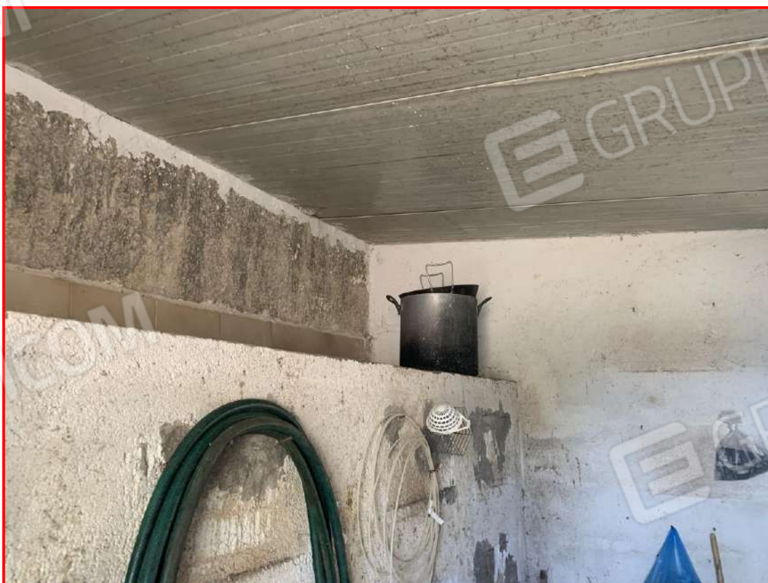
Foto n. 31 – Interni del corpo aggiuntivo senza titolo edilizio
