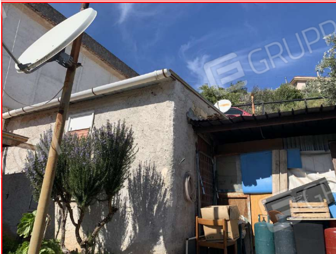
Foto n. 14 -Esterni del complesso immobiliare – Si rileva la presenza di corpi aggiuntivi senza titolo edilizio
