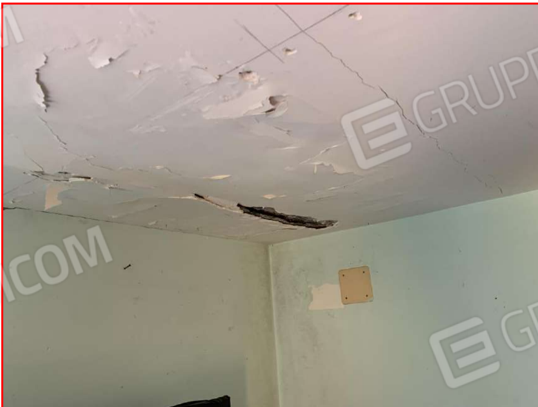
Foto n. 26 – Interni dell'unità immobiliare al Piano Seminterrato – Forte presenza di fenomeni infiltrativi di acque meteoriche che hanno compromesso il soffitto
