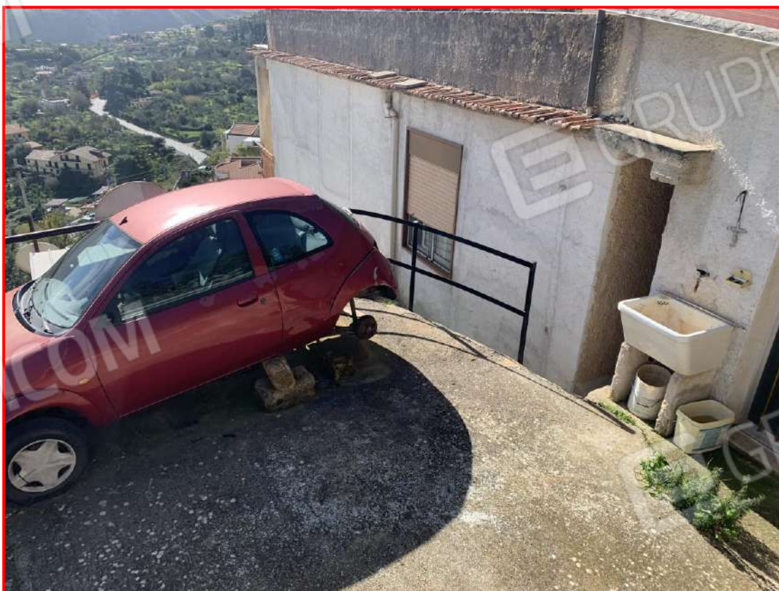
Foto n. 10 – Esterni del complesso immobiliare – Prospetto Est – si rileva la presenza di un corpo aggiunto senza titolo edilizio
