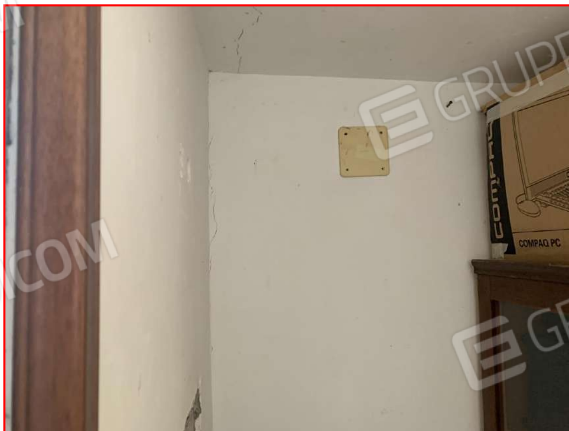
Foto n. 28 - Interni dell'unità immobiliare al Piano Seminterrato - si rileva la presenza di efflorescenza dovuta ad umidità di risalita
