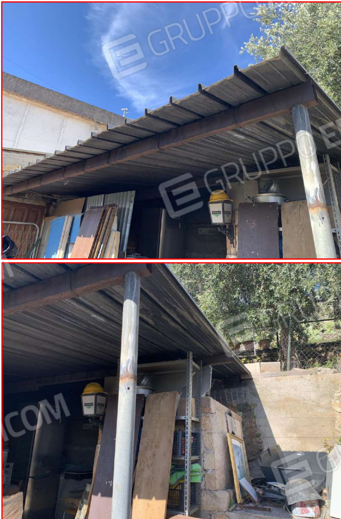
Foto n. 34 - Vista della tettoia senza titolo edilizio
