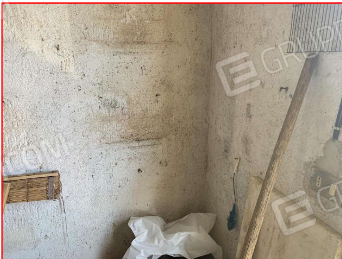
Foto n. 32 - Interni del corpo aggiuntivo senza titolo edilizio
