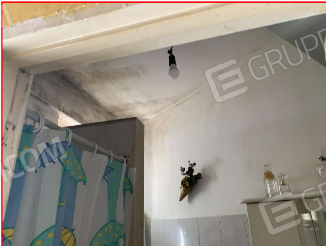
Foto n. 23 – Interno dell'unità immobiliare al Piano Primo – massiccia presenza di fenomeni infiltrativi di acque meteoriche che hanno compromesso l'intonaco
