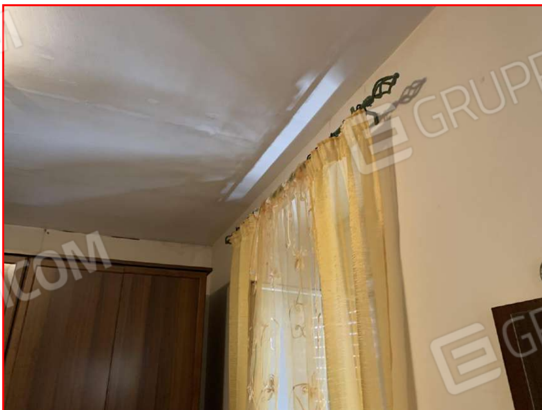
Foto n. 24 - Interno dell'unità immobiliare al Piano Primo -Camera da letto ricavata all'interno di un corpo aggiuntivo senza titolo edilizio. Si rileva la presenza di forti fenomeni infiltrativi di acque meteoriche che hanno compromesso parte della copertura e di fenomeni di umidità da risalita
