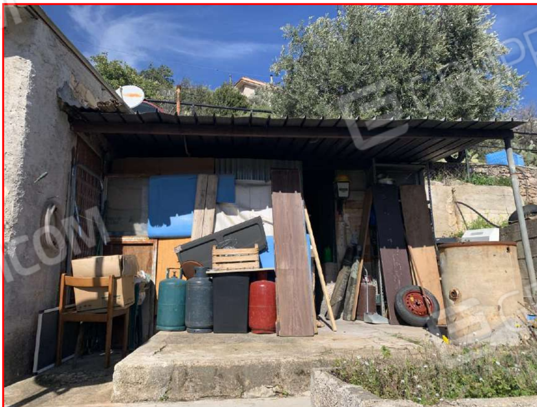
Foto n. 33 - Presenza di una tettoia priva di titolo edilizio in adiacenza al prospetto EST
