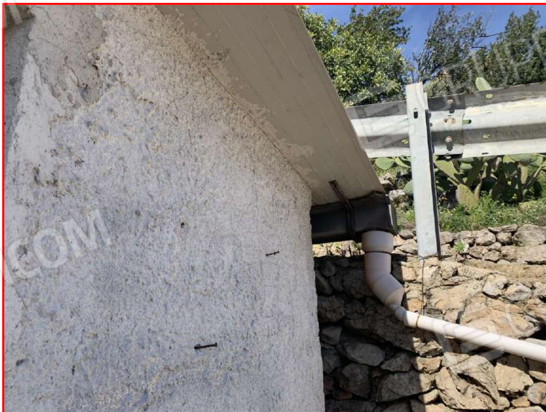
Foto n. 29 - Vista su accesso al corpo aggiuntivo senza titolo edilizio adiacente al prospetto Nord
