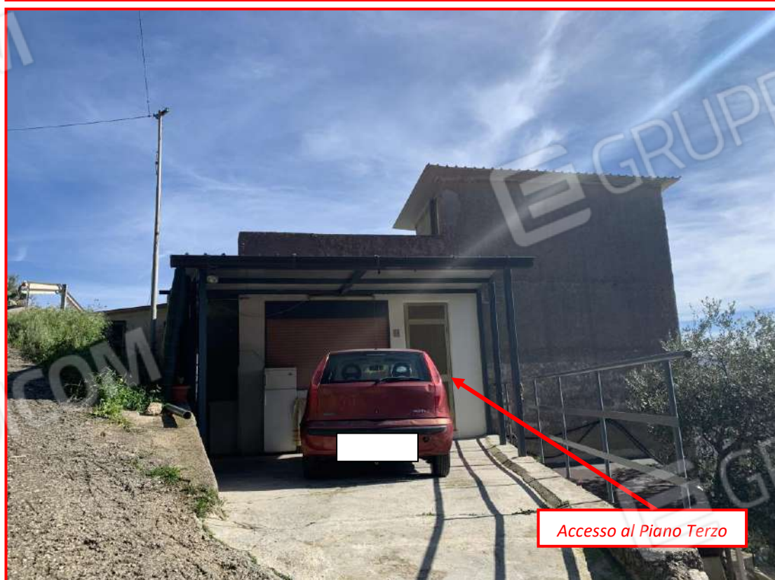
Foto n. 3 – Esterni del complesso immobiliare – Accessi da strada interpoderale – si rileva la presenza di una tettoia senza titolo edilizio
