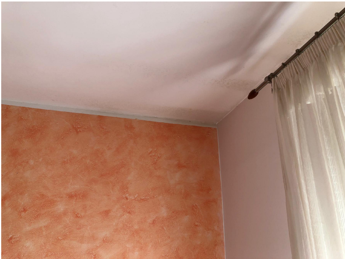
14-Vista interno macchia condensa - piano primo
