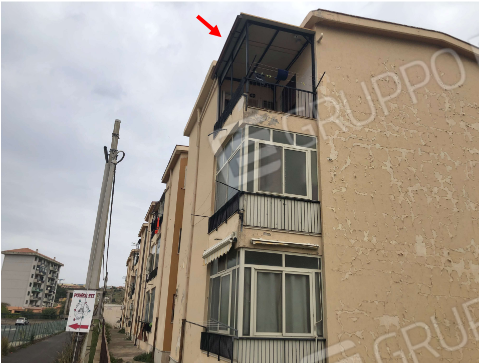
Foto 5: Vista prospetto Sud-Ovest della palazzina, la freccia indica la copertura del terrazzino realizzata in assenza di provvedimenti autorizzativi.
