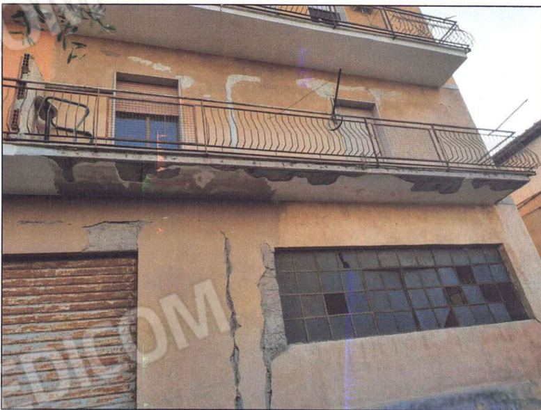
Foto 8 - I balconi sono degradati con mancanza di intonaco e calcestruzzo coprifermo, causati da infiltrazioni d'acqua. Anche il prospetto presenta l'intonaco danneggiato da macchie di umido e da dilavamento. Occorrono lavori di manutenzione straordinaria.
