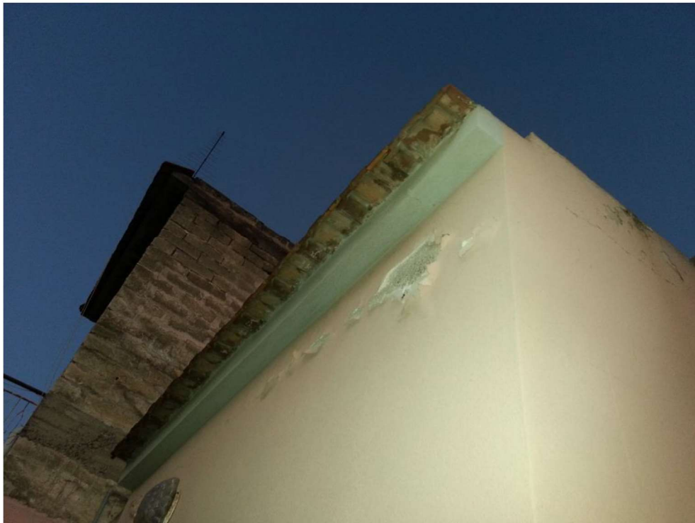
foto 12_ vista esterna del distacco d'intonaco
