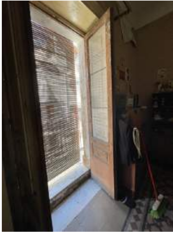
Fotografia D.13 - Piano primo: balcone che si affaccia sulla via Gioachino Rossini
