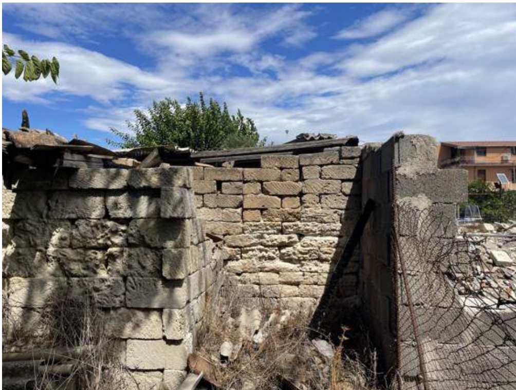
Fotografia D.62 - Manufatto al confine con la p.lla 636
