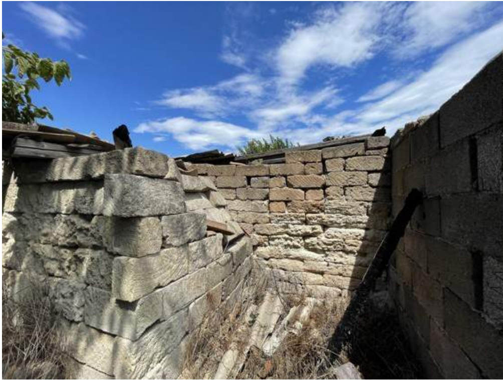
Fotografia D.61 - Manufatto al confine con la p.lla 636
