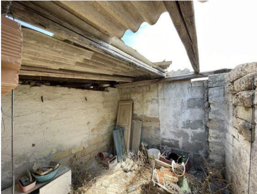
Fotografia D.59 - Interno e copertura precaria
