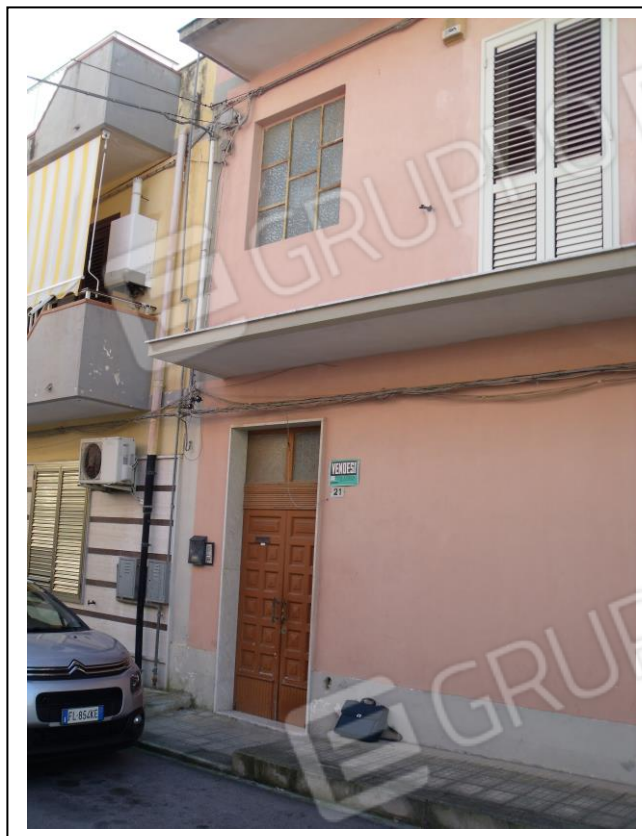
03. Prospetto nord su via Vittorio Alfieri, particolare su portone d'ingresso all'immobile e vetrata superiore del corpo scala. Presenza di balcone privo di ringhiera.
