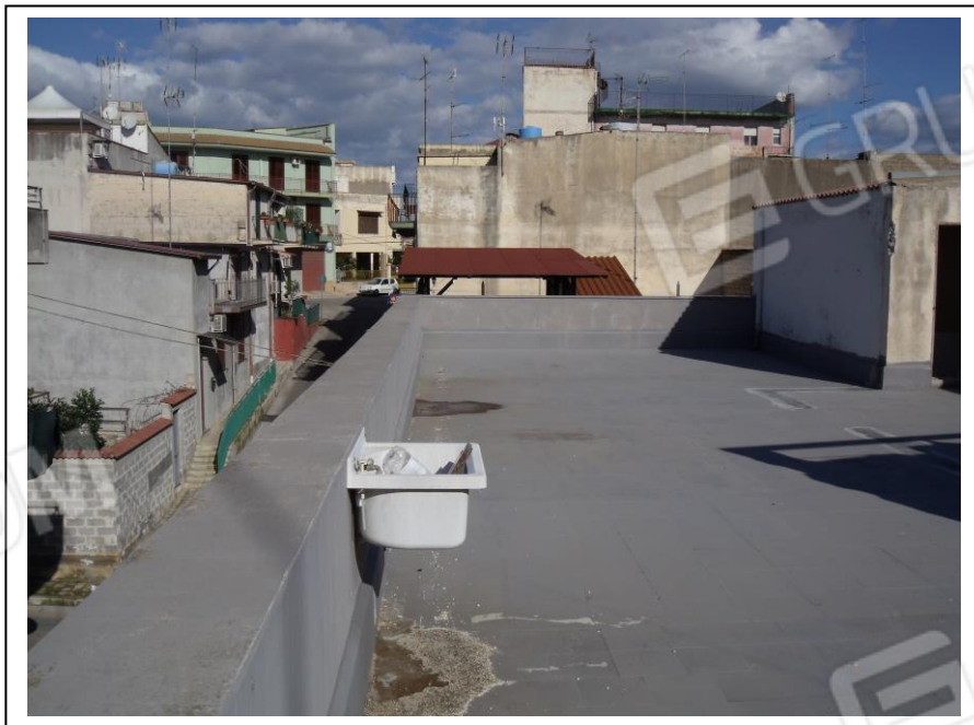
11. Esterno dell'immobile con vista su piano terrazza al piano secondo, presenza di un parziale stato di degrado.
