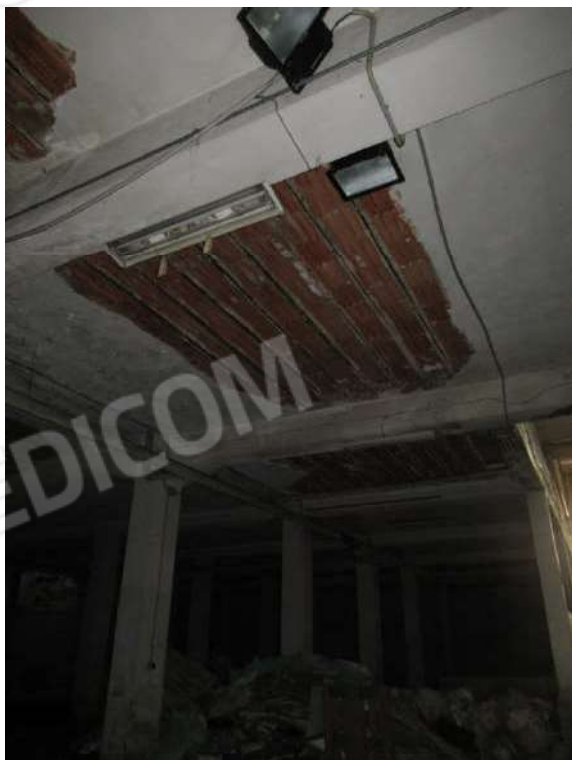
Foto 12_ Caduta intonaco su solaio
