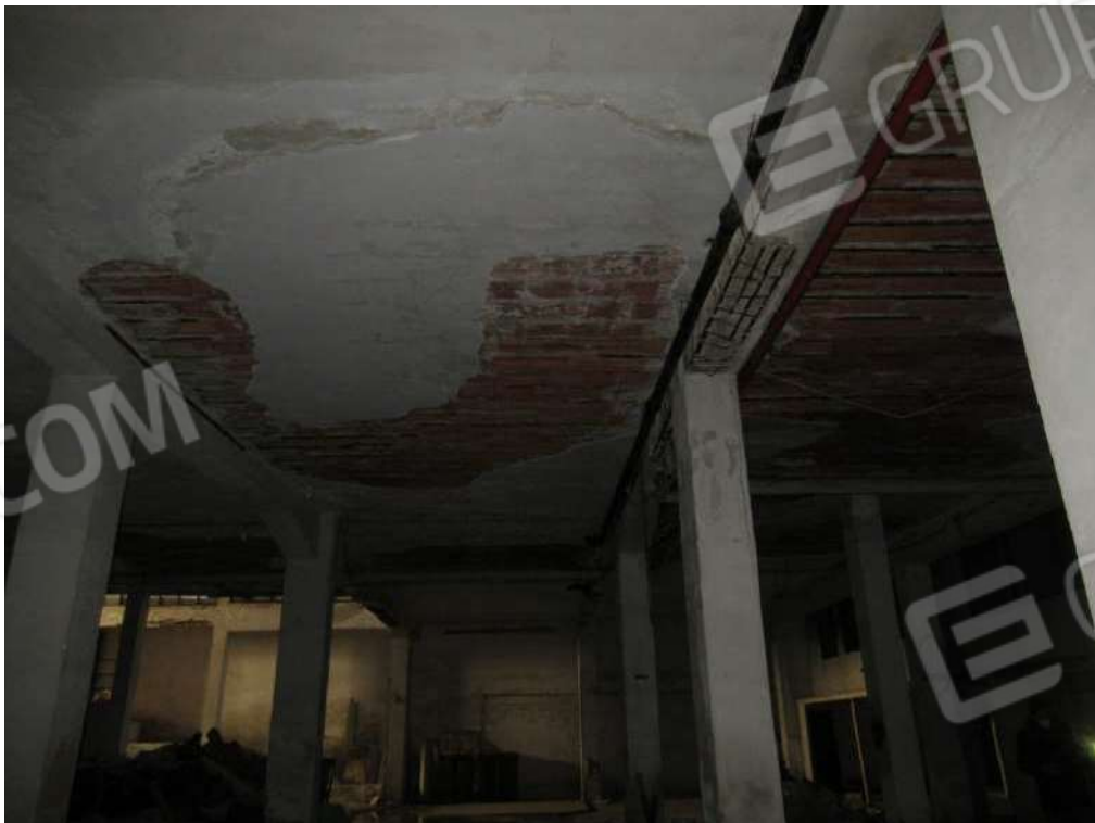
Foto 10_ Caduta intonaco su solaio
