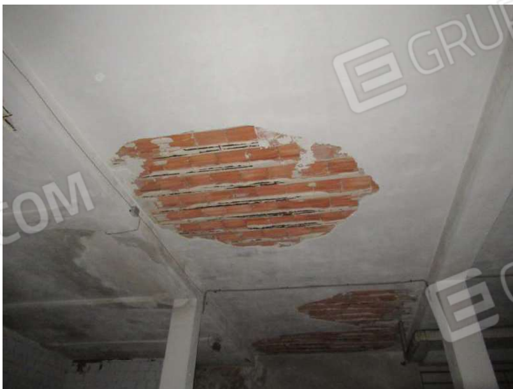
Foto 15_ Caduta intonaco su solaio e tracce di umidità
