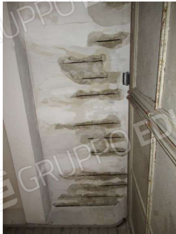
Foto 2_ Caduta intonaco copriferro su solaio
