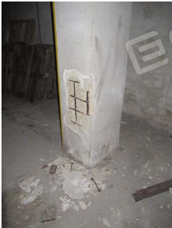
Foto 1_ Caduta intonaco copriferro
