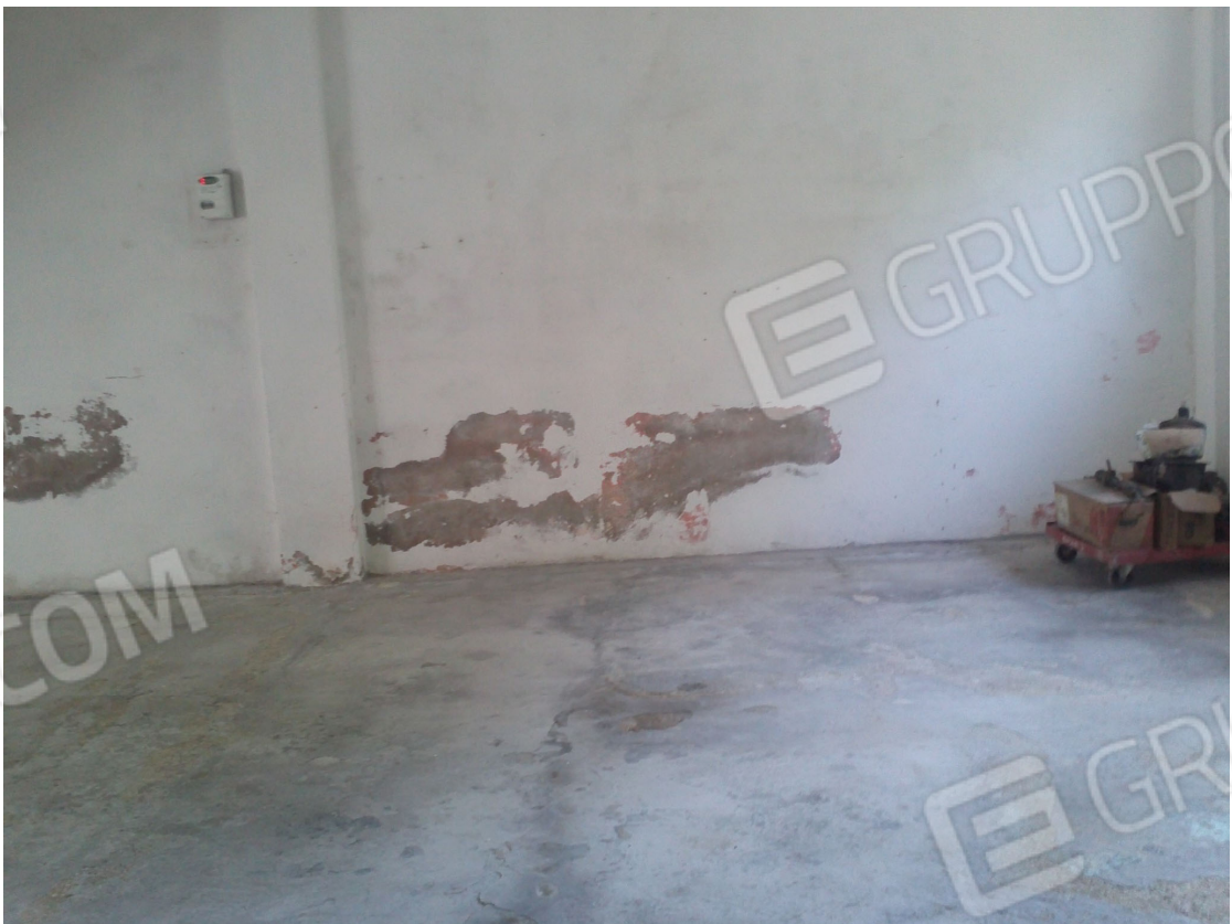
Foto 04. Umidità all'interno degli immobili.
