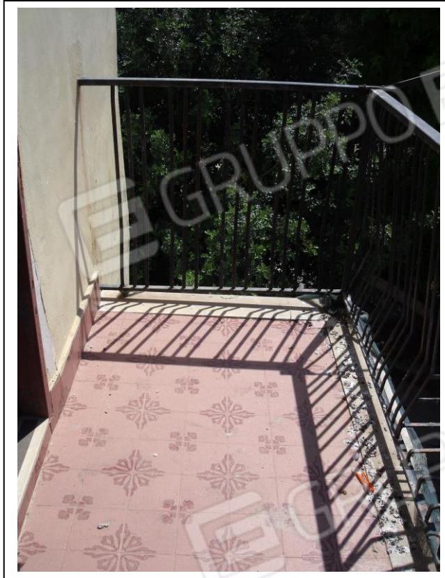
30. Esterno all'u. i. con vista balcone verso lato est, in scarse condizioni di manutenzione.
