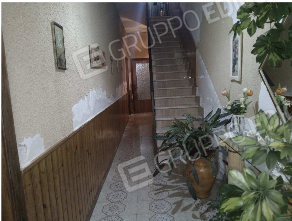
Foto n. 3: Androne d'ingresso (si nota umidità da risalita presente sulla parete a sx)
